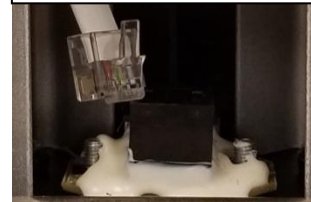
Câble de cellule de pesage non connecté
